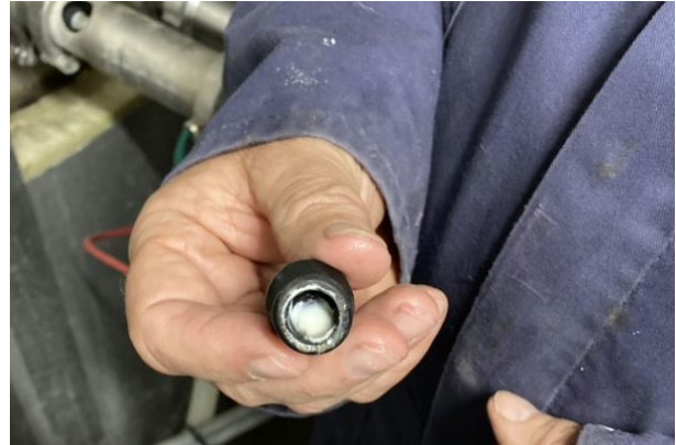
Foto 9: Melkresten zichtbaar op het dopje van het staalnamekraantje van de koeltank.
