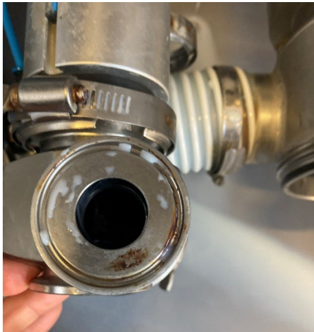
Foto 12: Roest op koppeling tast het oppervlak aan wat een goede aansluiting kan verhinderen en opstapeling van melkresten kan veroorzaken
