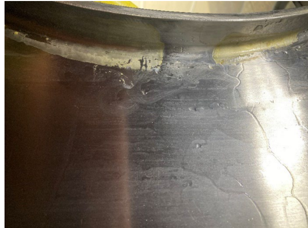
Foto 24: Vervuiling zichtbaar aan de rand van het mangat.
